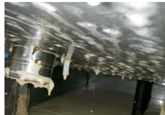
Tvorba biofilmu na krytu systému, který je vysokým zdrojem rekontaminace pro terstvé chladicí kapaliny
